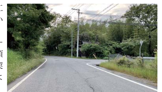
危険なカーブ対策が急がれる県道
