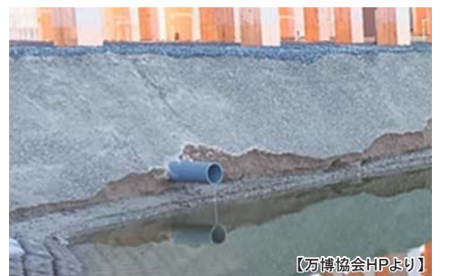
不安材料が増した大屋根護岸浸食
